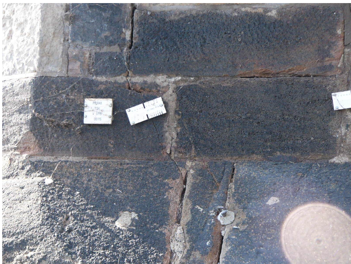
Obrázek 15: Rozpukané zdivo pilíře č. 8
