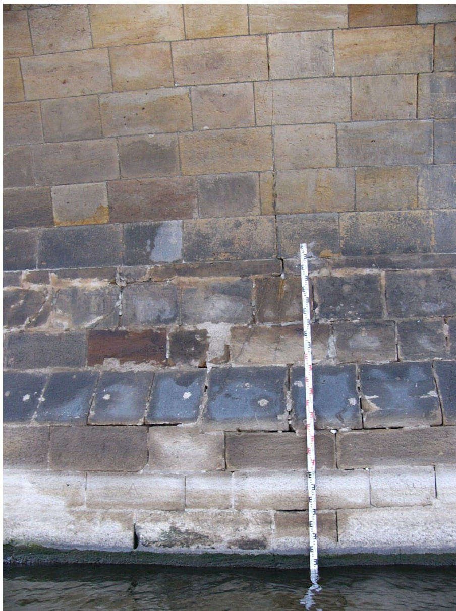
Obrázek 16: Degradace pojiva ve zdivu pilíře č. 8
