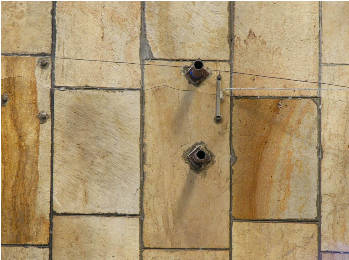
Obrázek 10: Obraz zdiva s měřidly deformace na klenbě č. 6
